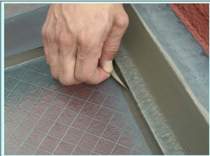
同上 シーリング材の劣化状況
