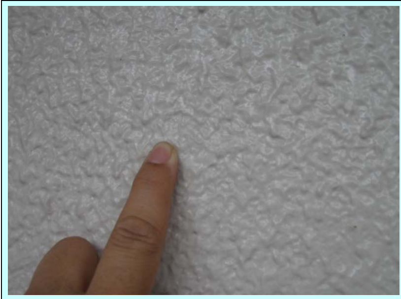
共用廊下内壁 塗膜の劣化状況
