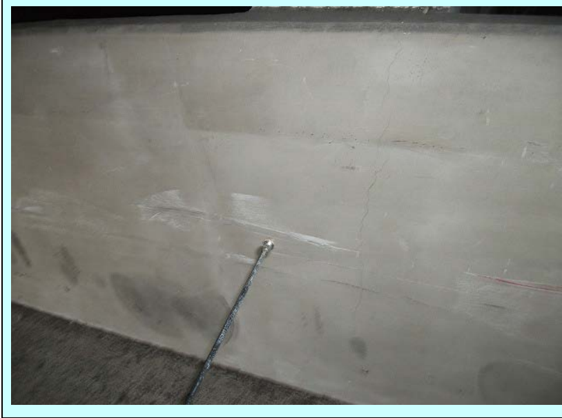
地下駐車場 駐車場壁ひび割れ状況
