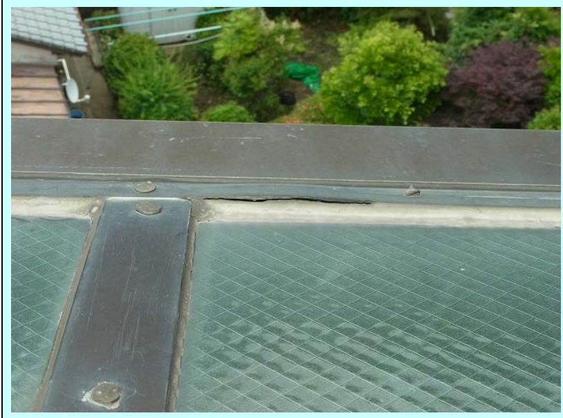
最上階ベランダガラス屋根 シーリング材の劣化状況
