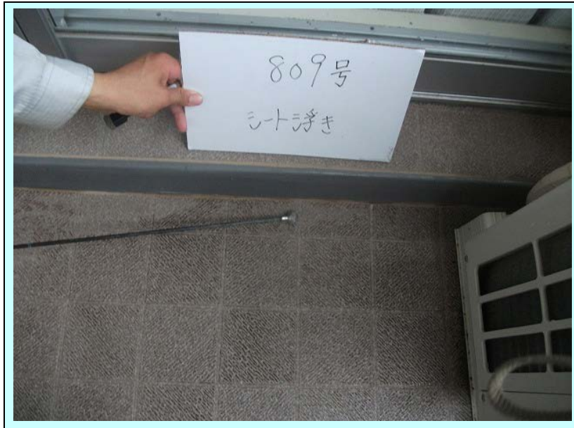
ベランダ床面長尺シートの浮き
