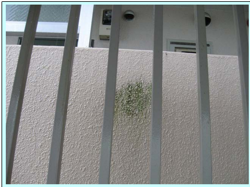
微生物による汚染状況
