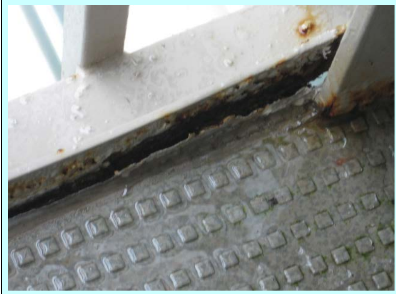
鉄骨階段床面 シート取り合い部錆発生 状況
