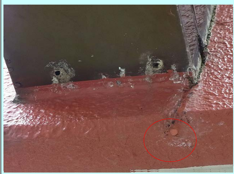
最上階ガラス屋根、鉄骨部 劣化状況
