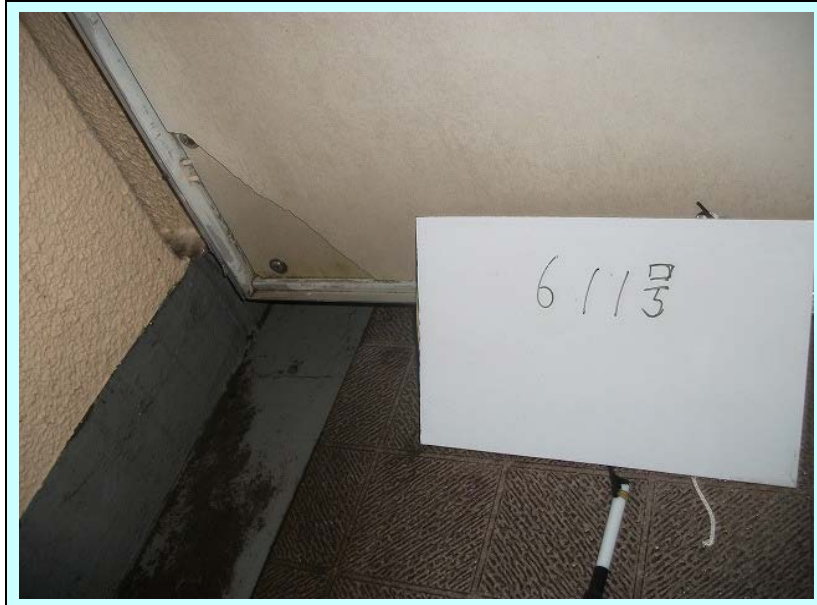
隔て板劣化状況
