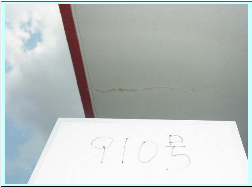
専有部軒天 ひび割れの発生状況
