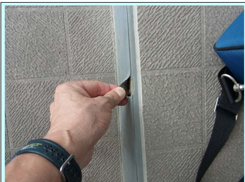
ベランダ床長尺シート シ-リング材の劣化状況 一部であるが確認された
