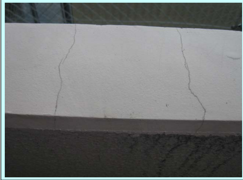
共用廊下手摺天端 ひび割れの発生状況
