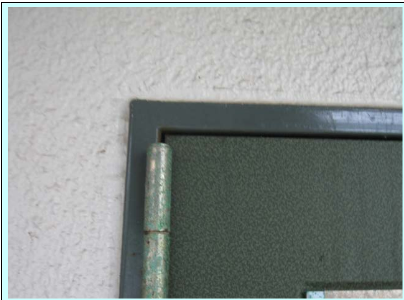
各戸玄関 三方枠塗装劣化状況
