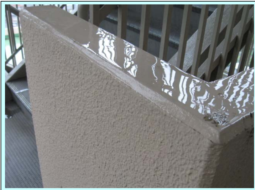
共用廊下手摺壁 塗膜状況
